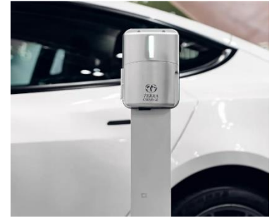
電気自動車充電設備 (公社ビル)
